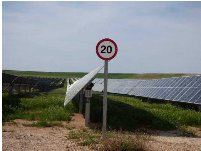
Imagen 5: Señal de límite de velocidad situada en uno de los viales del parque fotovoltaico.
